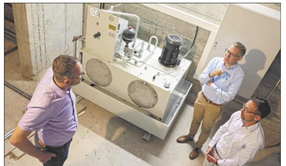
Neue Technik steuert die Hebewand zwischen Aula und Musiksaal am Limes-Gymnasium.
