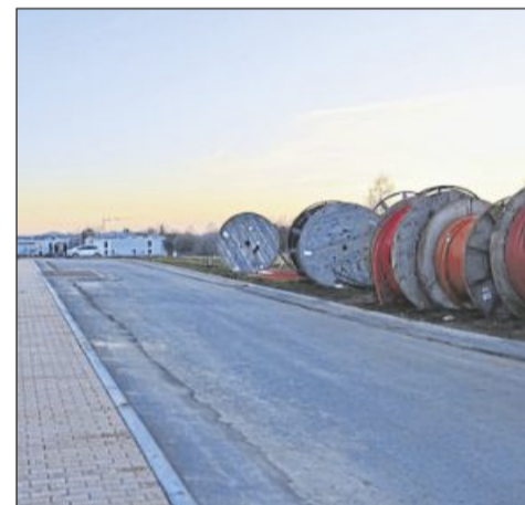
Kabelrollen liegen bereit. Foto: Sofia Shahaievska
